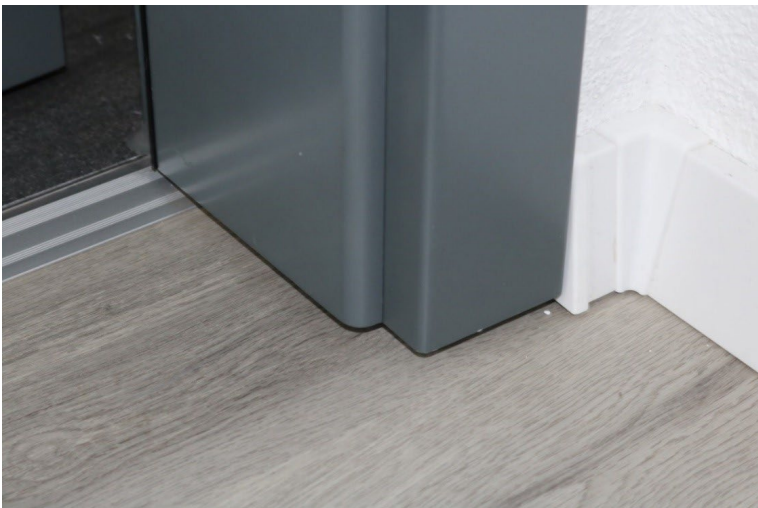
Unzulässiger Anschluss bei einem Vinylboden
